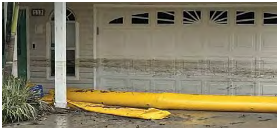
Una barrera contra inundaciones no pudo proteger esta casa de la marejada. Foto del Times.
